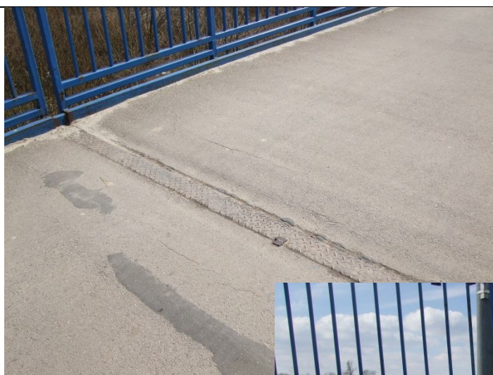
Widoczne nieszczelne dylatacje; przęsłowa i podporowa
