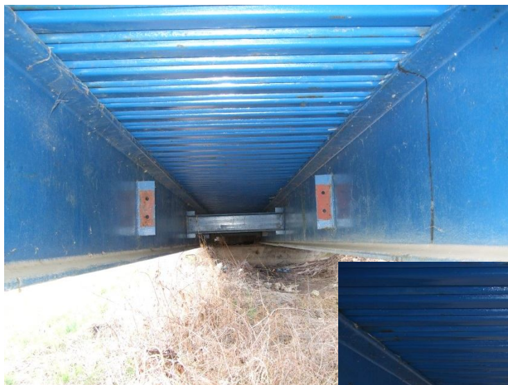
Widoczne brakujące poprzecznice stalowe w przęśle IX
